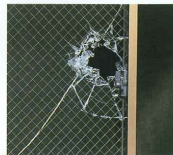
網入板ガラス ガラスが砕け、一枚ガラスと同様、クレセントを回せる穴が簡単に開きました。
