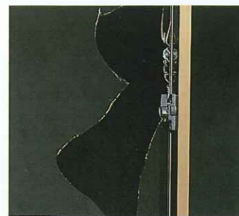
一枚ガラス（フロート板ガラス） ガラスが砕け落ち、クレセントを簡単に回せる穴が瞬間で開きました。
